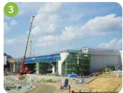
3 菅野交差点付近 専用部の橋梁は、桁の架設が完了し、床版工事を実施しています。また一般部も橋梁工事に着手しました。
