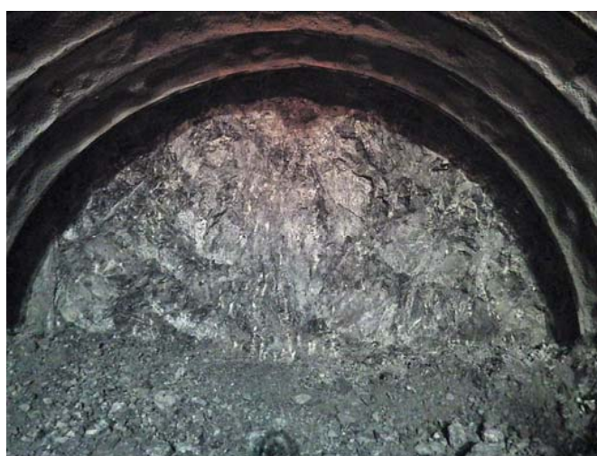
下り線切羽状況 STA.137+75.0 TD=1,505.0m C II -b 湿り(切羽)、70L/min(下り線全体)
