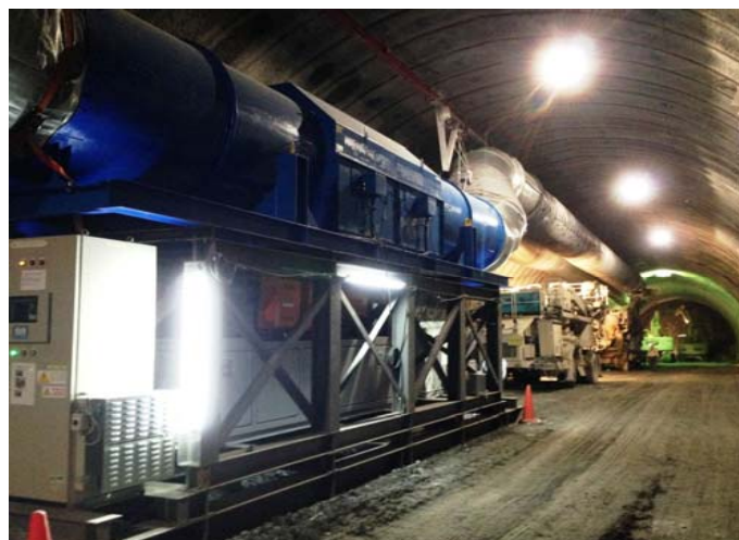
上り線坑内(換気台車)
